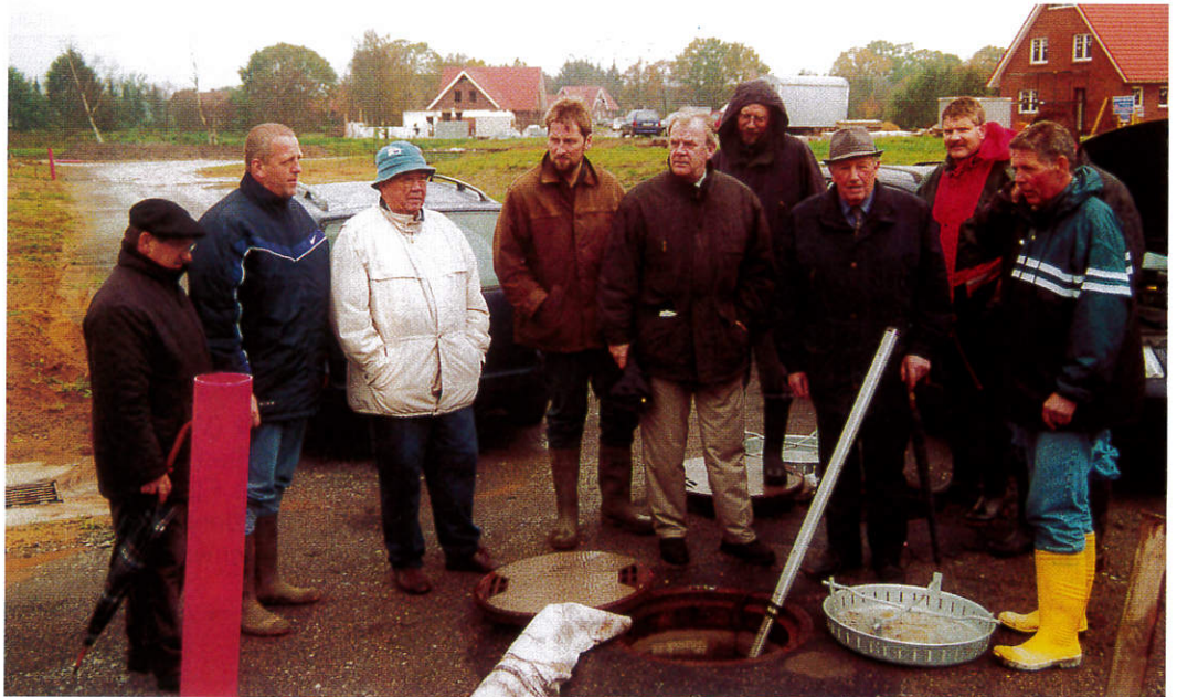
Die Abnahmekommission mit Vertretern der Gemeinde, der ausführenden Firma sowie der Kremer-Klärsgesellschaft Hesel, die für die Planung und Bauleitung zuständig war.
